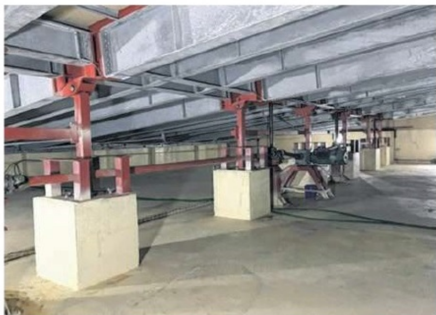
Sous la grande salle, des vérins permettent d'abaisser le plancher.
